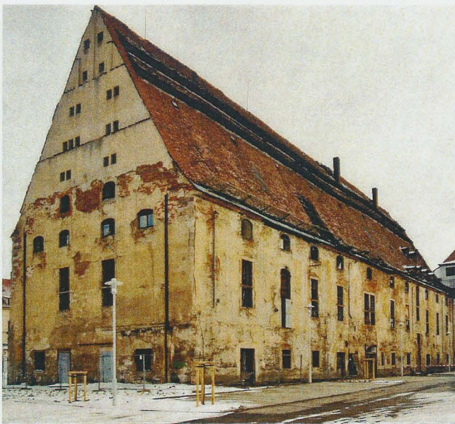
4 Kornhaus von Südwesten: Zustand vor der Notsicherung.
