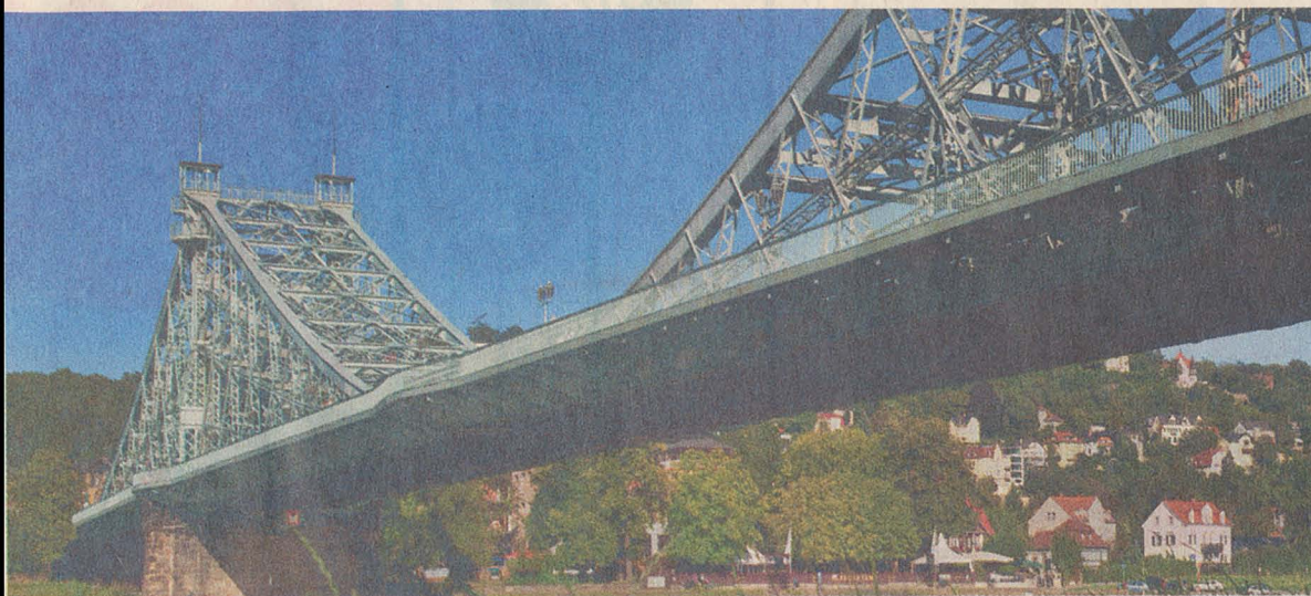
„Blaues Wunder“ in Dresden – Zeugnis deutscher Ingenieurskunst in der Tradition des Zwickauer Stahlbaus
